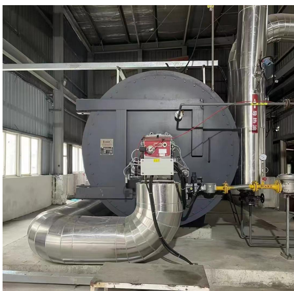
天然气锅炉（3用1备）
