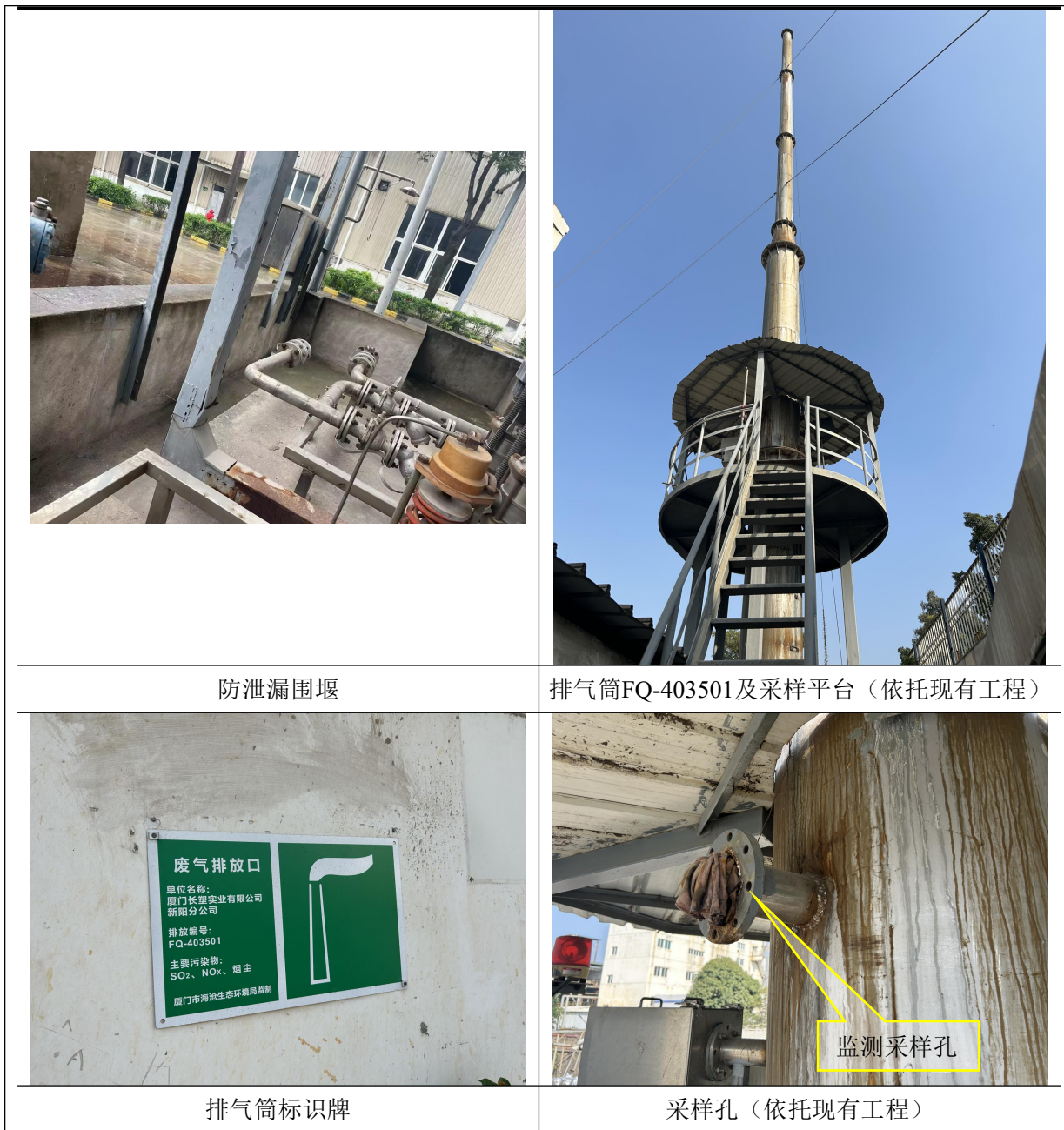
图 3-1 项目废气处理设施现场图
